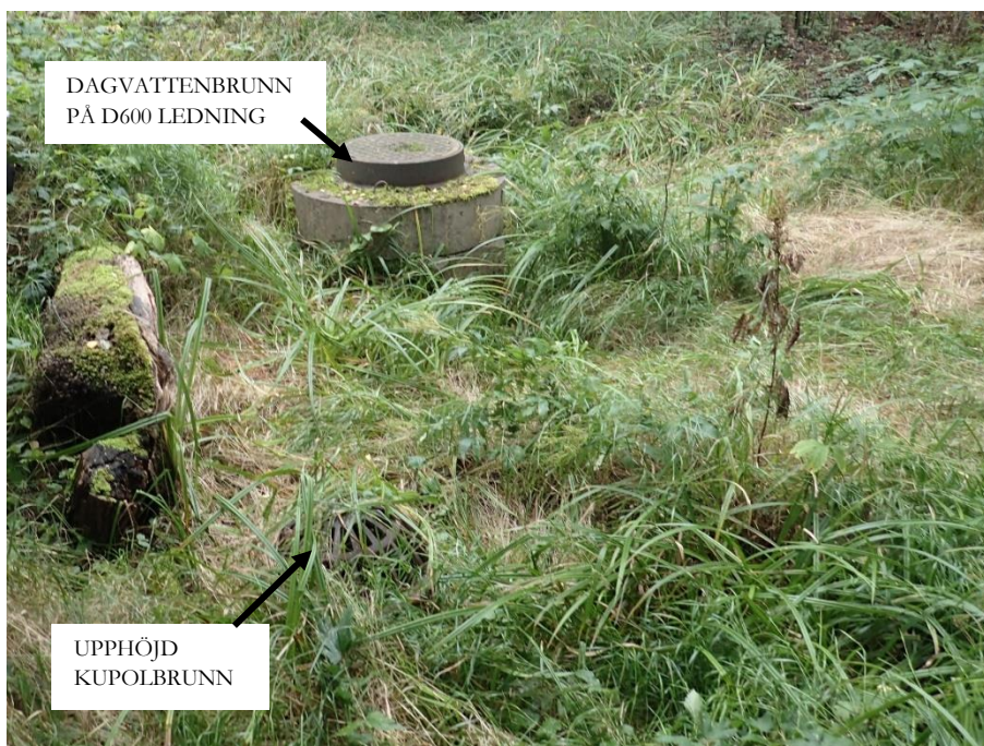
Figur 7 Lågstråk med dagvattenbrunn och upphöjd kupolbrunn
