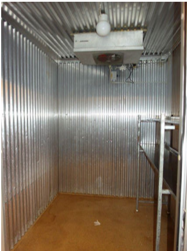
Ett av tre kylrum klädda med korrugerad stålplåt. 173 – 175.
