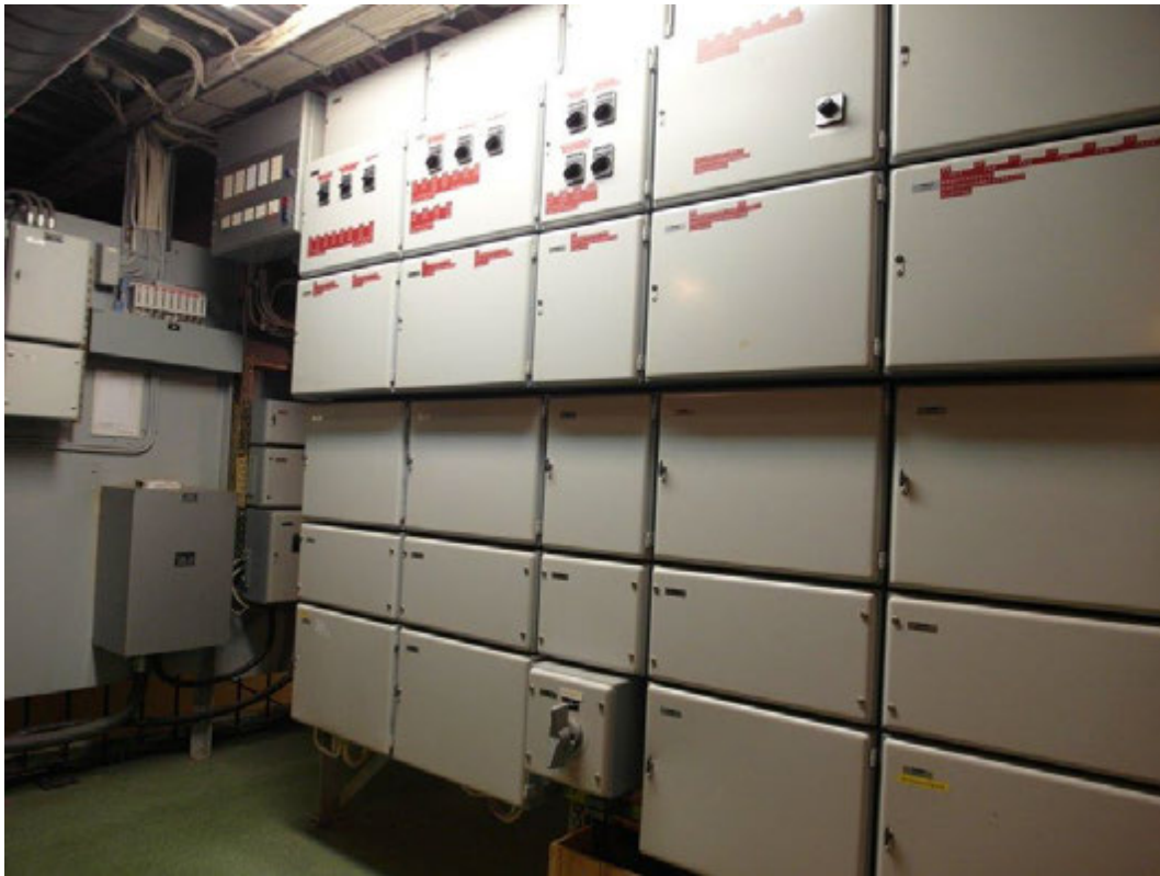
Elcentral i fläktrummet.
