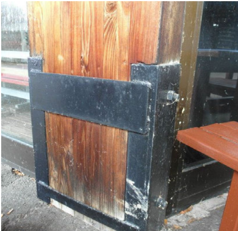
Utanpåliggande limträbalk med bultade järn.
